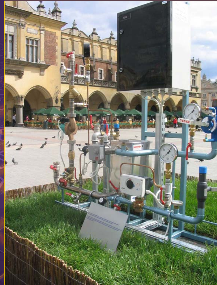
Nowoczesny kompaktowy węzeł ciepłowniczy wyprodukowany przez MPEC S.A.
